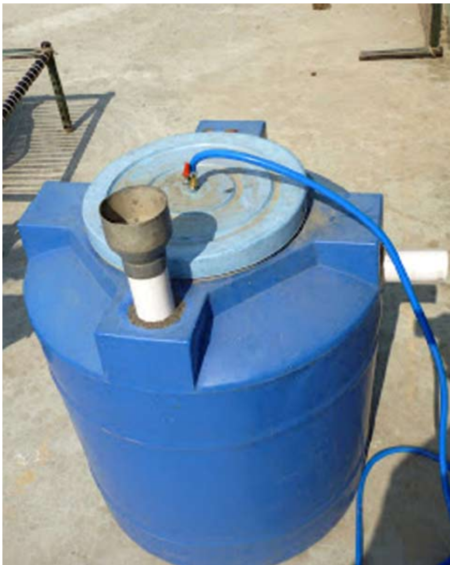
Mini-instalação doméstica fixa de Biogás em autoconstrução.
